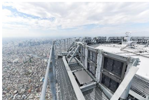
△スカイツリーに実際に設置された ライティング用の照明機器
